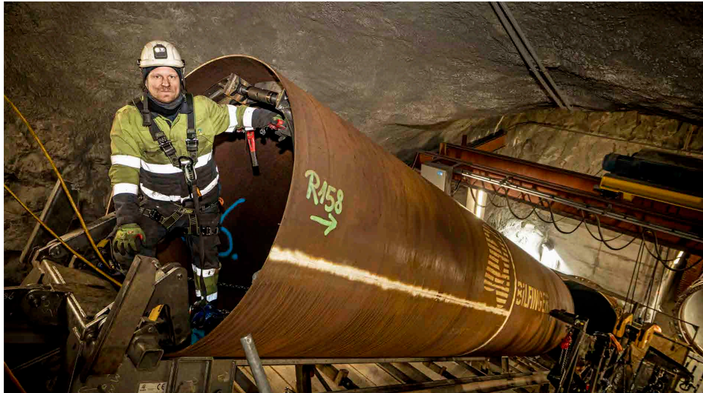
Obermonteur Jan Seben (Firma Bilfinger) in der Kaverne, von wo die Rohre für den unteren Abschnitt der Leitung eingefädelt werden.
